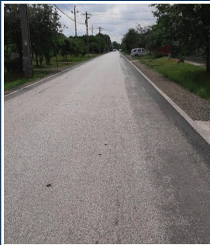
Dózsa György út a templomtól a buszfordulóig terjedő szakaszának felújítása - Önerős beruházás Br: 19.607.000 Ft
